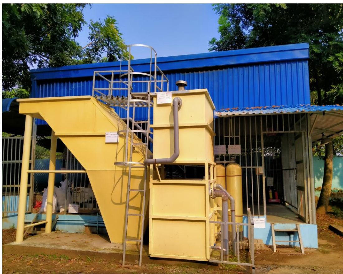
Hình 3. 9 Công trình xử lý nước thải sản xuất
